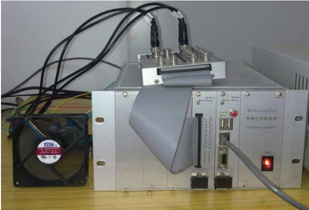
Fig. 6. Cooling fan control test rig
